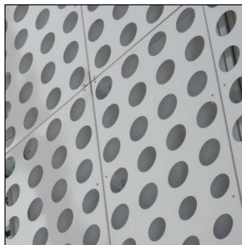
Figur 11. Perforerad fasad med bakomliggande ljudabsorbent.
